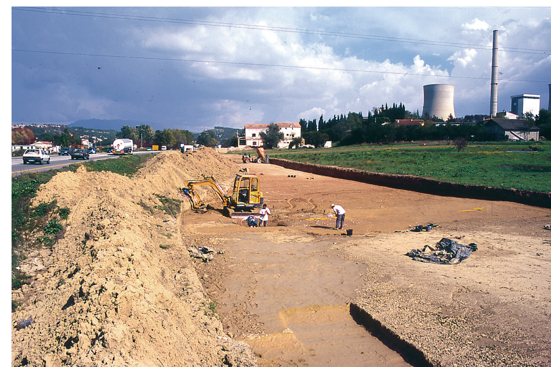
2- La fouille se développe sous la forme d'un linéaire large de 25 m pour une longueur totale de 200 m. La mise en sécurité du chantier a nécessité l'édification d'un merlon de terre, amputant une partie du décapage. (cf. A. Hasler / Inrap).
