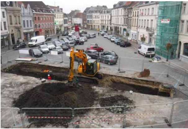
Fig. 14 : tranchée TR1 en cours de fouille. La pelle mécanique est positionnée sur sa zone de travail. © Alain Henton - Inrap.
