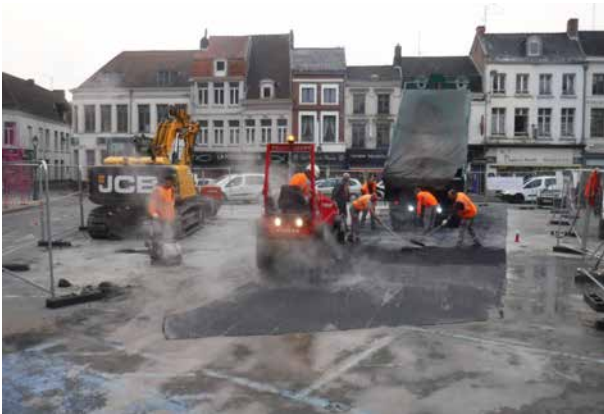
Fig.6 : remise en état de la place après la fin de la phase 1 (TR1). Pose d'un nouvel enrobé par la société Eiffage.
