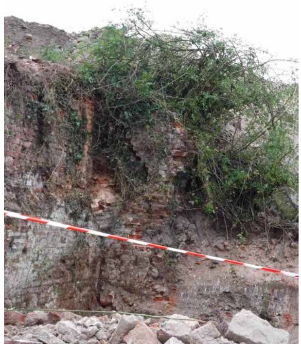
Fig.9 : mur latéral sud de la cave 1. Risque d'effondrement imminent. Sécurisation des abords. © Evelyne Gillet - Inrap.
