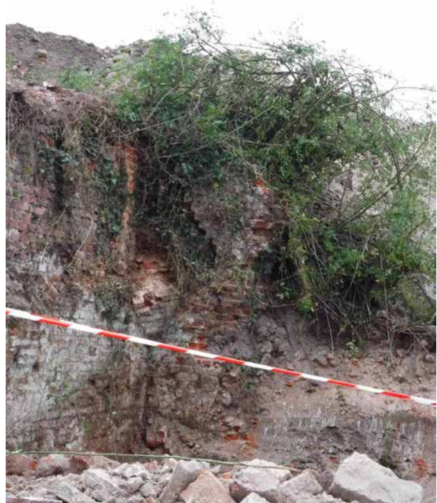
Fig.9 : mur latéral sud de la cave 1. Risque d'effondrement imminent. Sécurisation des abords. © Evelyne Gillet - Inrap.
