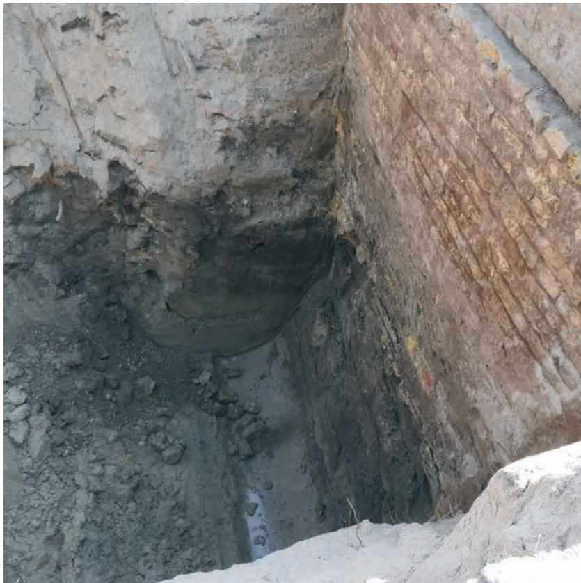
Fig. 25 : Vue du fond du Sondage 6 en relation avec le mur 7 au moment de l'apparition de l'eau Cliché © Thierry Marcy - Inrap
