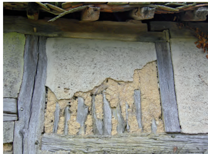
Fig. 20 : Détail de clayonnage en terre et bois sur un édifice moderne, Vallée de la Besbre (03). © P. Mille.
