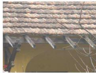
Etat de la couverture en tuile
