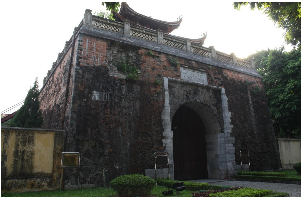
Fig.46. Porte Nord, les traces du bombardement de 1882. Etat actuel.
