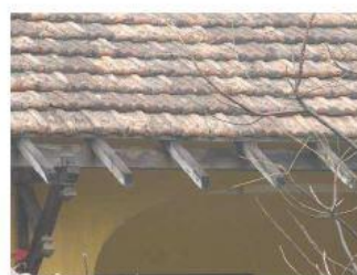
Etat de la couverture en tuile
