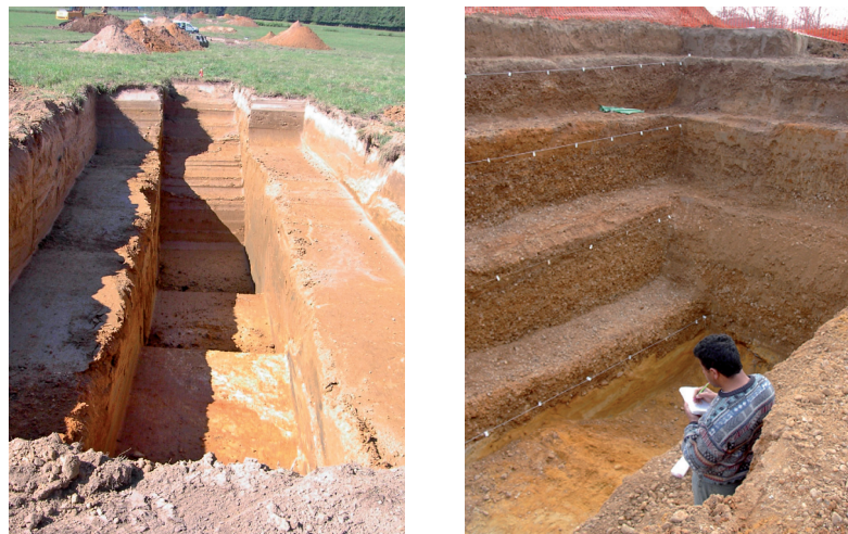
Fig. 4. Exemples de sondages profonds mis en sécurité (déviation de Bergerac, d'après Bourguignon et al. 2003).
