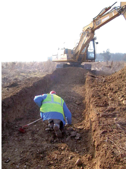
Fig. 4. Exemple de maillage adapté lors du diagnostic de la déviation de la RD820 à Cressensac. La réalisation du sondage central, qui descend à 6 m de profondeur au cœur de la doline 1, a nécessité deux jours. © cliché M. Jarry, Inrap ; dessin O. Onézime et M. Jarry, Inrap.
