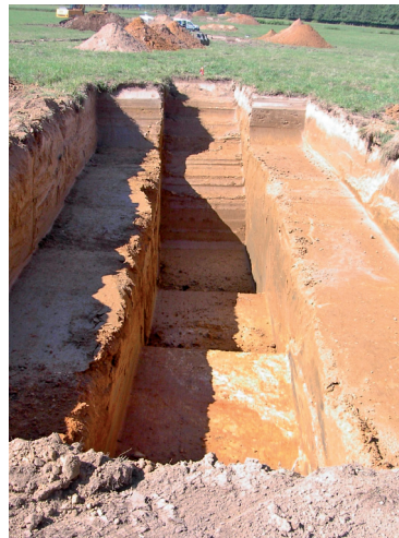
Fig. 4. Exemples de sondages profonds mis en sécurité (déviation de Bergerac, d'après Bourguignon et al. 2003).
