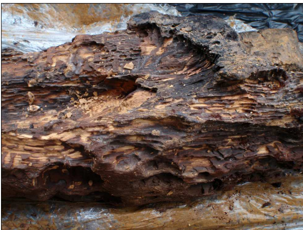
Fig. 3.11-05 : Dégradation des poutres du puits 15758 : résultat d'une attaque par des champignons, destruction de la lignine (perte de coloration du bois ; cl. B. Lecomte-Schmitt, Inrap)
