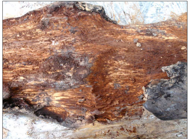
Fig. 3.11-05 bis : Dégradation des poutres du puits 15758 : la poudre brune résulte de l'attaque par des insectes et leurs larves (cl. B. Lecomte-Schmitt, Inrap)
