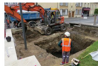
Installation borne de recyclage du verre rue Larcher, Bayeux - 2016 - CD14
