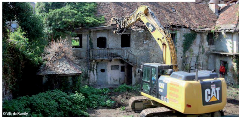
Capture d'écran de la démolition de la maison du 5 rue Charles de Gaulle
