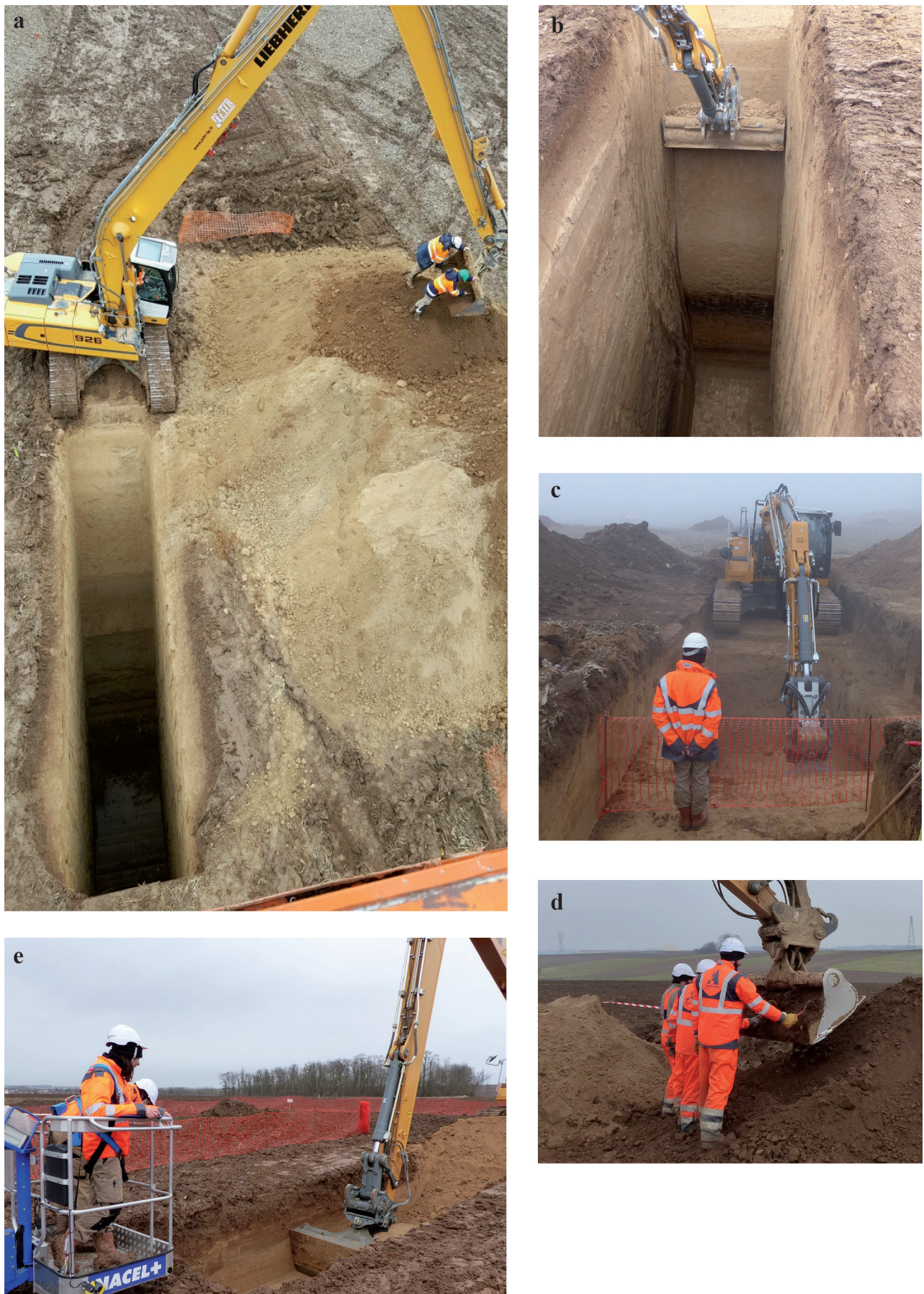
Fig. 8 - Méthodes employées pour la réalisation des diagnostics : a et b – exemples de sondages en puits réalisés à l'aide de la pelle hydraulique à bras rallongé (N. Schneider, Inrap) ; c – plateforme d'observation mise en place lors d'un sondage en puits à la pelle hydraulique (F. Bachelierie, AA) ; d – contrôle manuel du contenu du godet (F. Bachelierie, AA) ; e – nacelle utilisée pour l'observation des logs stratigraphiques lors des sondages réalisés à la pelle à bras rallongée (F. Bachelierie, AA). AA = Archéologie Alsace.
