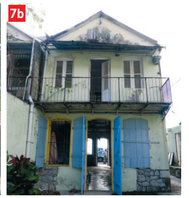
7b Villa Sainte-Anne, Saint-Pierre, Martinique. Première étude d'un bâtiment post éruption.
