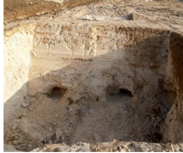
Galerie non comblée à la base du puits
