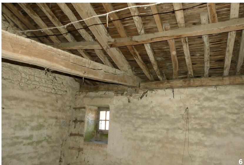
Fig. 6 - Foussais, Maison François Laurens, combles, détail d'une ferme de charpente. Assemblage de l'entrait sur les sablières et des liernes sur l'arbalétrier. (J. Pascal, Inrap)
