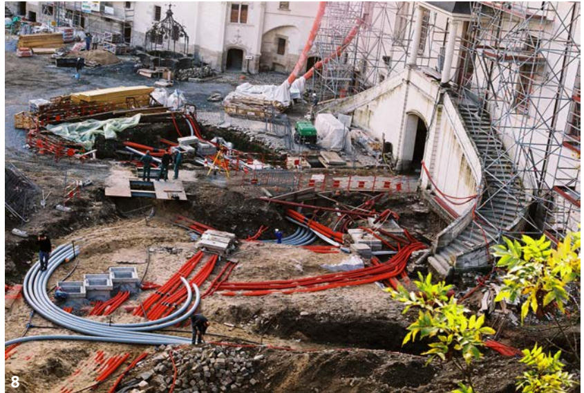
Fig. 8 - Nantes, château des Ducs de Bretagne, travaux dans la cour, au nord-ouest, au pied du Grand Gouvernement. (J. Pascal, Inrap)
