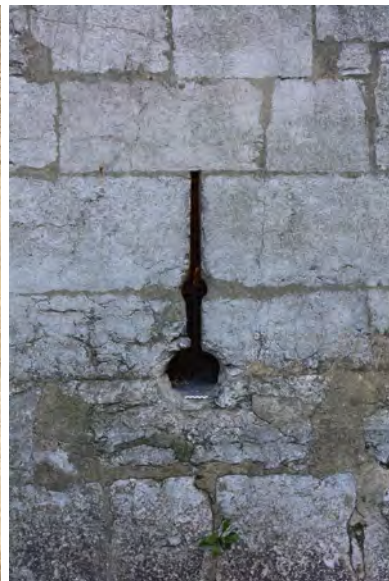
Fig. 40 : Château de Chambéry. Canonnière à louche CAN 2 de la salle d'artillerie vue depuis la rue. Cliché : L. D'Agostino.
