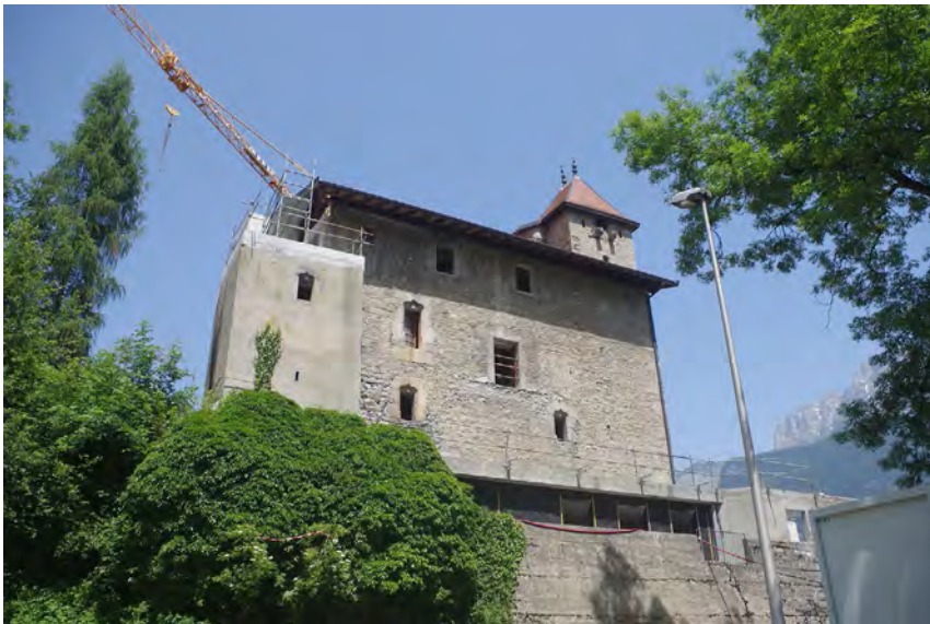
Fig. 6 : Maison forte des Rubins (Sallanches, 74). Détail de la façade sud de la maison forte. Cliché : L. Benoit.
