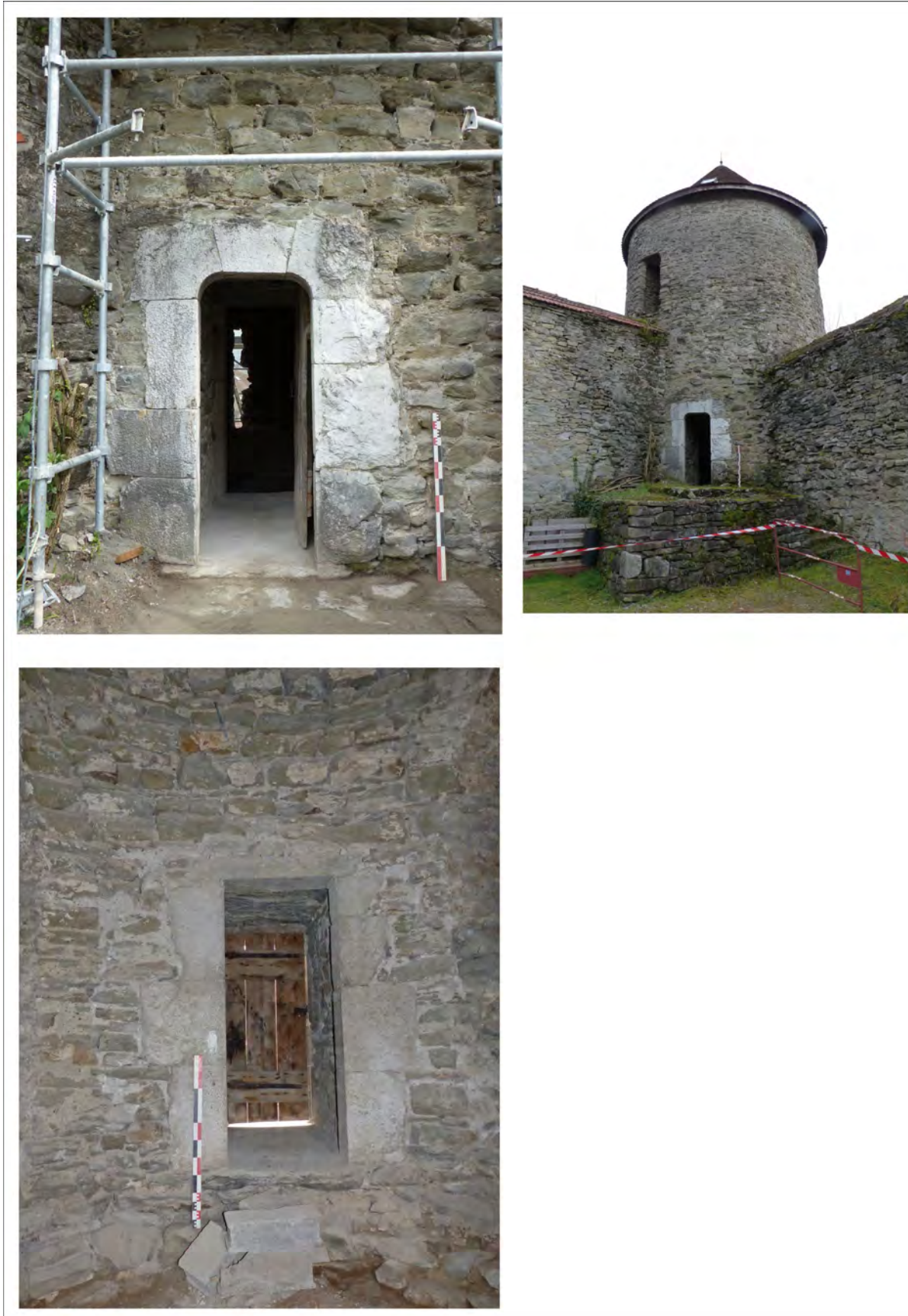
Fig. 47 : La porte PR 3020=3027 de la tour sud-est : à l'extérieur vers le sud-est (en haut) et à l'intérieur vers le nord-est (en bas). Clichés : S. Bocquet, Inrap
