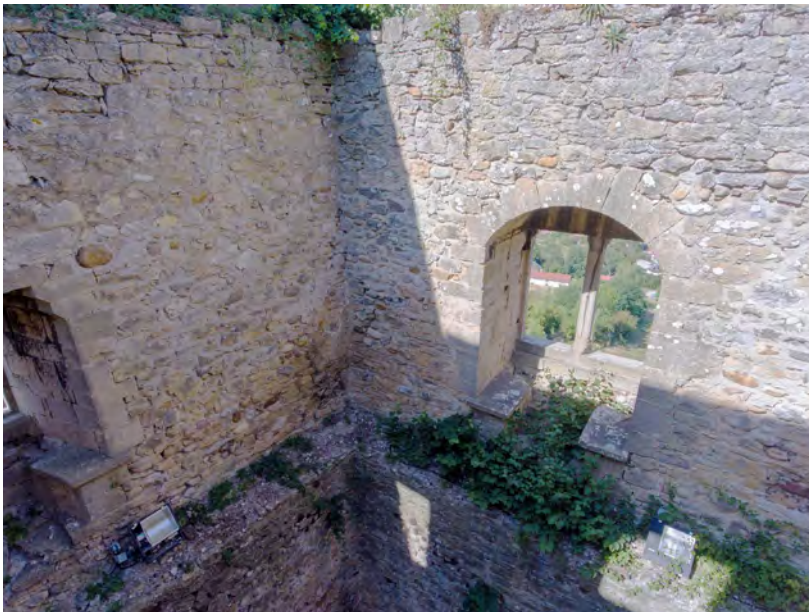
Fig. 26 : Tour de Saint-Denis. 1er étage, baie gémée à deux coussièges et ressaut. Cliché : J. Laidebeur.
