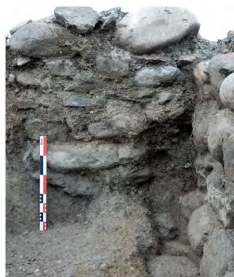
Fig. 15 : Château d'Épagny. Photographie générale du mur F1002 et de ses chemisages F1022 et F1054 depuis le nord-est (A). Relevé en coupe du mur F1054. Échelle 1 : 20. Photographie en coupe de l'extrémité nord du mur F1054. Clichés : Équipe de fouille.
