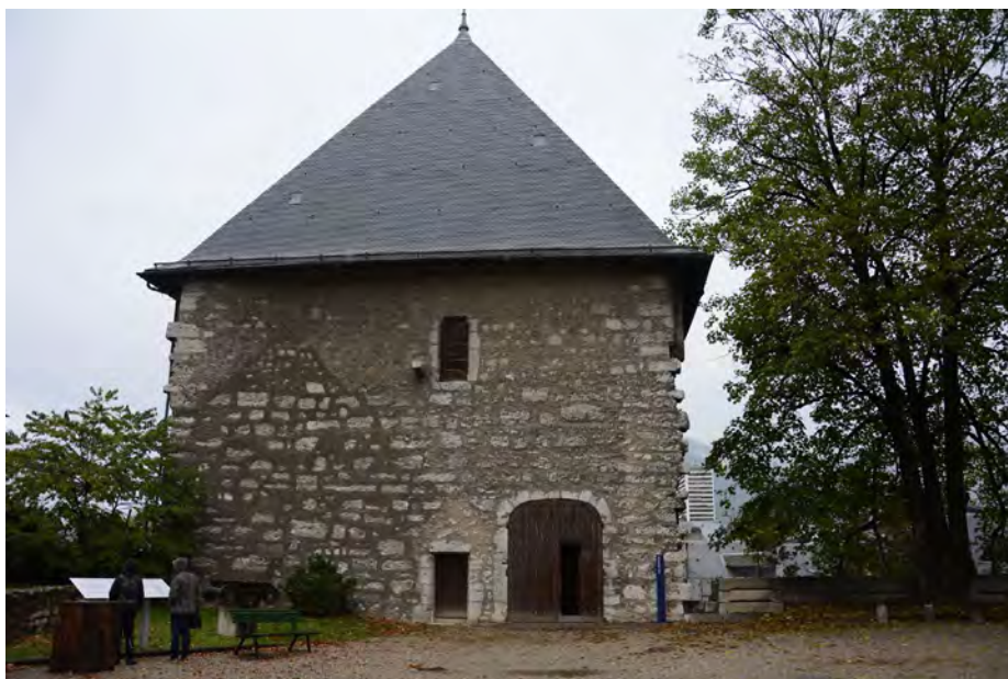
Fig. 47 : Château de Chambéry. Portes d'accès aux étages de la Tour Trésorerie depuis la cour. Cliché : L. D'Agostino.
