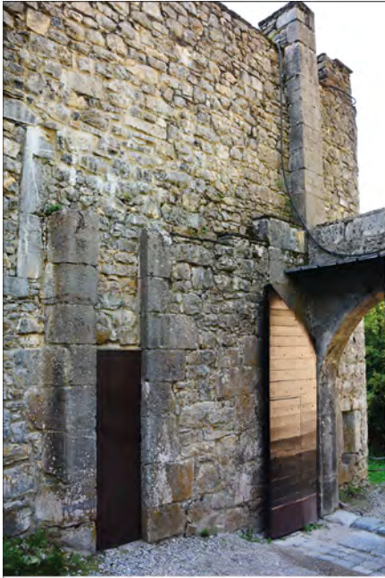
Rainure de herse de la porte d'accès au bâtiment sud et reconstruction de la partie haute.
