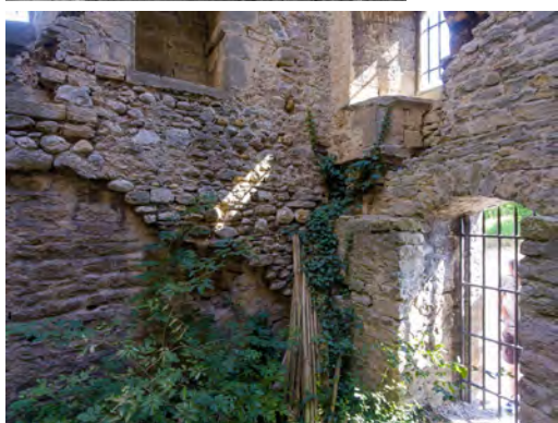
Fig. 21 : Tour de Saint-Denis. RDC, porte actuelle et reprises des maçonneries. Cliché : J. Laidebeur.
