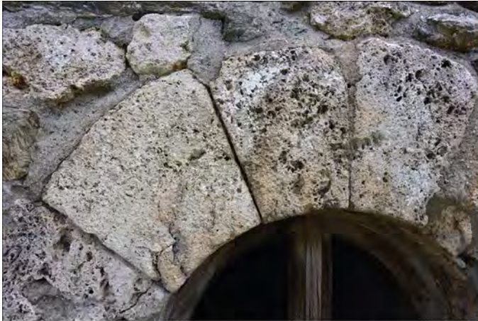
Claveaux en tuf de l'arc en plein cintre. Reprise des joints et consolidations au ciment.
