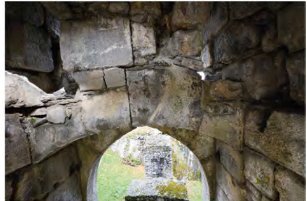
Passage des flèches, partiellement bouché.
