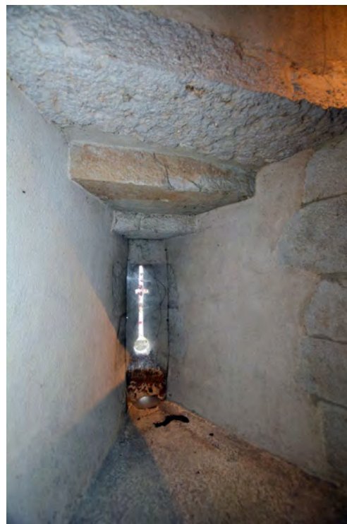
Fig. 28 : Château d'Annecy. Tour et Logis Perrière (ES 6 et 7), archère-canonnière à croisillon de la cuisine et évacuation d'eaux usées. Doc. : L. D'Agostino.
