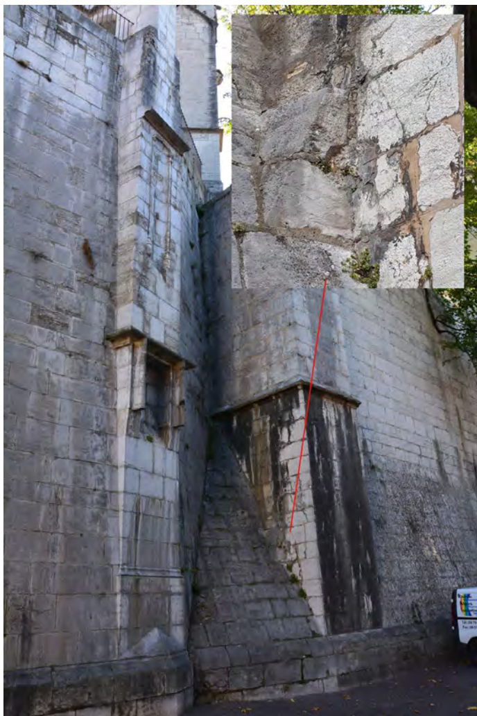
Fig. 51 : Château de Chambéry. Canonnière aménagée dans l'angle d'un contrefort vers la Sainte-Chapelle. Clichés : C. Mani et L. D'Agostino.
