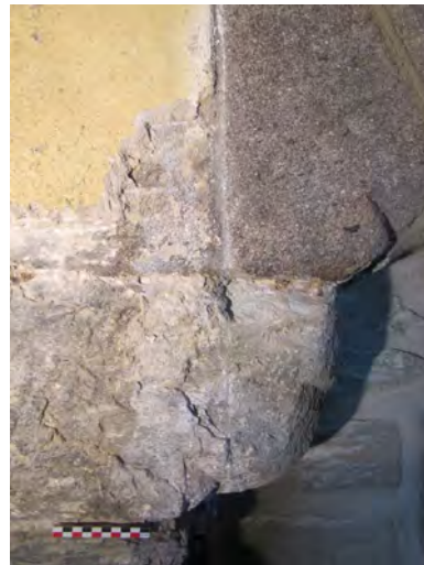
Fig. 14 : Château de Buffavent (Lully, 74). Détail du culot est de la cheminée CH1045. Cliché. : M. Caillet, Hadès
