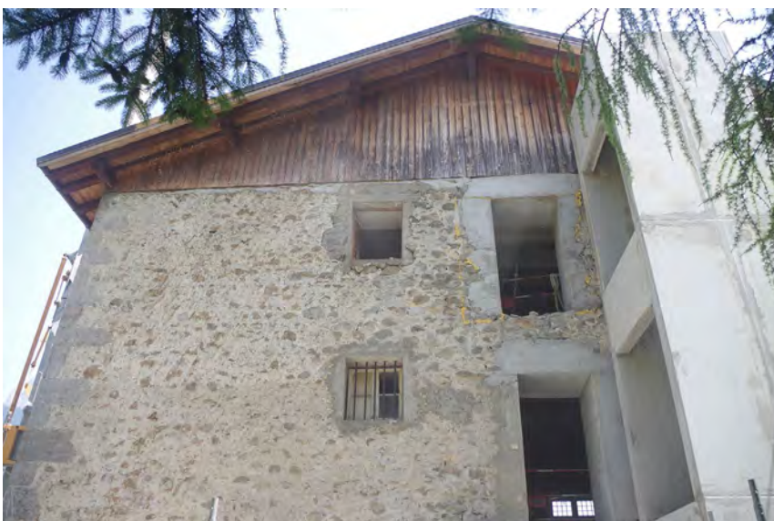
Fig. 7 : Maison forte des Rubins (Sallanches, 74). Extrait de la façade occi- dentale. Cliché : L. Benoit.
