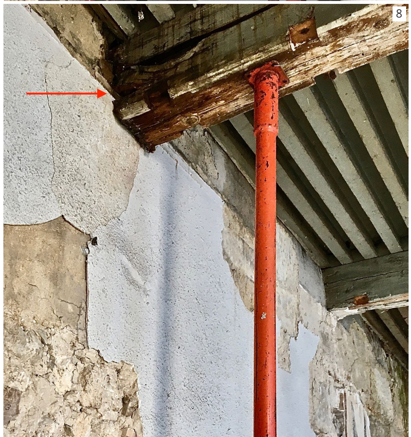
Fig. 7 - Romans-sur-Isère, hôtel de Loulle. Escalier monumental, vue de la volée reliant R+1 et R+2. Trois marches sont totalement désolidarisées des limons. (Cliché : Ch. Delomier, Inrap)
