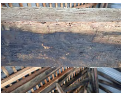
Fig. 232. (ci-dessous). Traces de carbonisation superficielle sur la face inférieure d'un entrait retroussé (C. Perrault / CEDRE).
