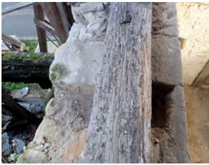
Fig. 234. Réserve creusée au sommet du mur gouttereau nord entre les fermes F3 et F9 (C. Perrault / CEDRE).
