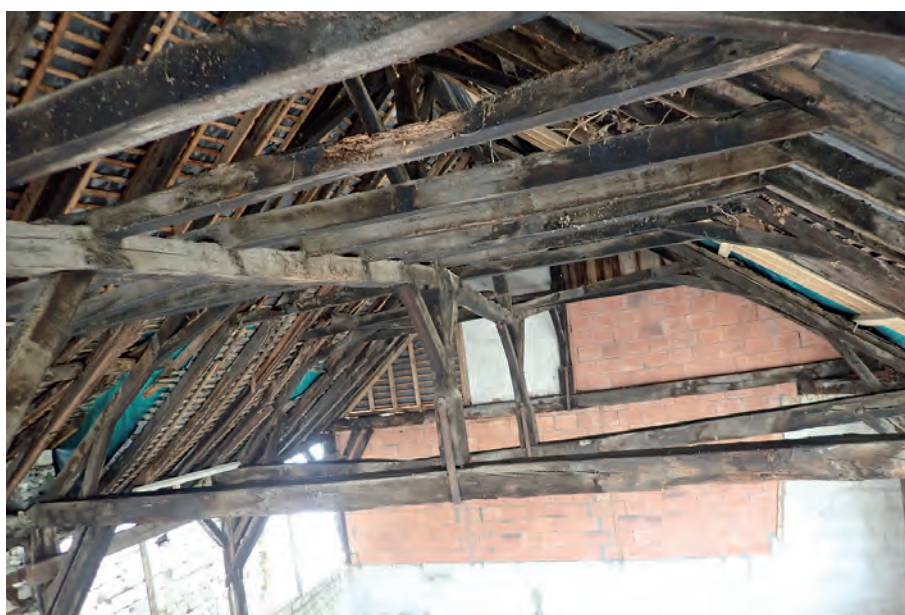
Fig. 231. (ci-contre). Affaissement de l'entrait de l'avant-dernière ferme depuis le pignon ouest et du sous-fâitage au niveau de la ferme F44 (C. Perrault / CEDRE).
