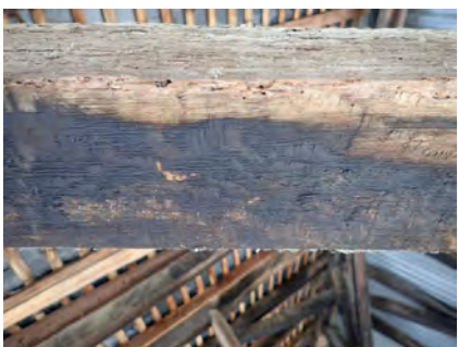
Fig. 232. (ci-dessous). Traces de carbonisation superficielle sur la face inférieure d'un entrait retroussé (C. Perrault / CEDRE).
