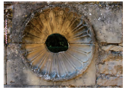
Fig. 42. Vue de l'oculus ornant la partie sud-ouest et permettant d'éclairer la galerie ouest (G. Roquefort).
