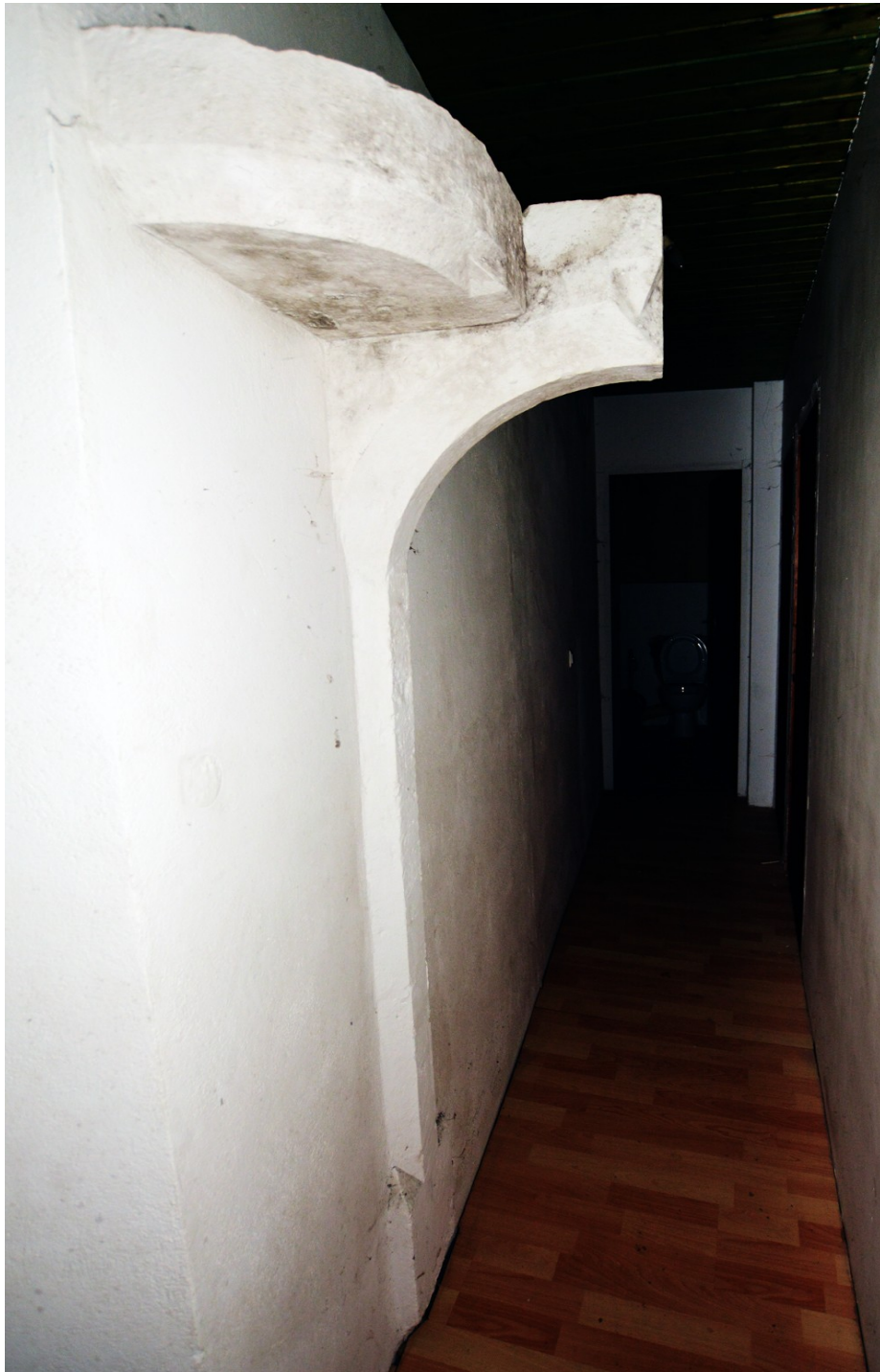
Figure 172 : Mionnaz (74). Vestige de cheminée de la camera du 1er étage du logis. Cliché : E. Chauvin-Desfleurs.
