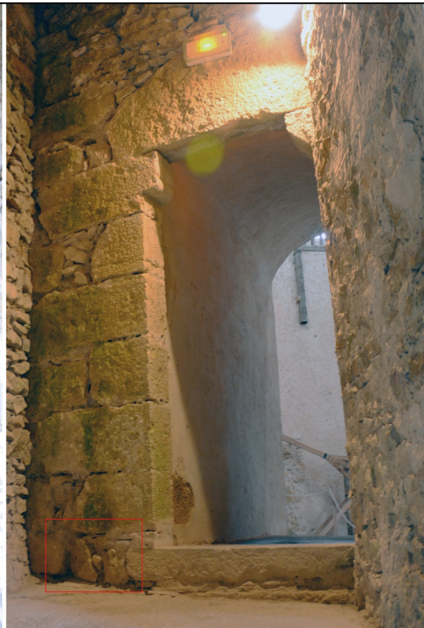
Piédroit nord, tableau et arrière voussure enduits. En bas, corbeau bûché ?
