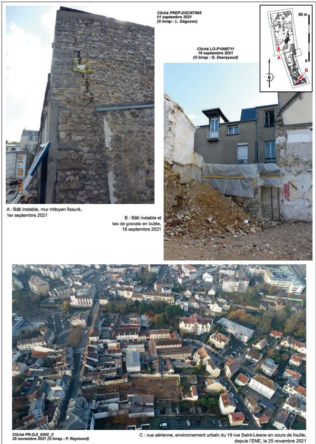
Fig. II-01-05 Melun, 19 rue Saint-Liesne. Exemples de bâti mitoyen instable et environnement urbain © Inrap : L. Daguzon, G. Desrayaud, P. Raymond
